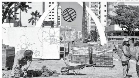
Um trecho da obra - que tomava o contorno da Avenida Dom Luís - foi liberado por estar finalizado
