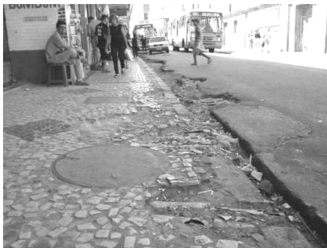
Figura 3.14: Exemplo de calçada degradada no Centro de Fortaleza-CE (2005).
