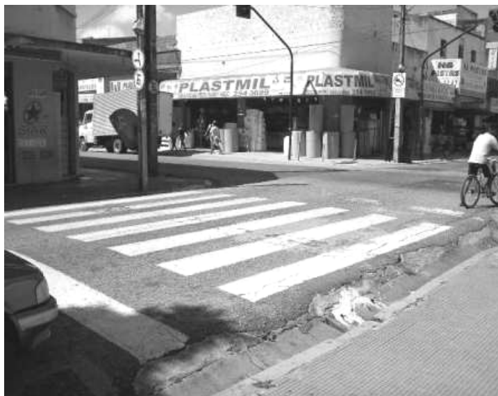
Figura 3.6: Desnível do leito carroçável da via em relação à calçada no Centro de Fortaleza-CE (2005).
